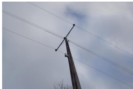
Kortslutningsindikator som indikerer lokalt med blinkende LED, og har batteri og modem for å sende informasjon via mobilnettet.
