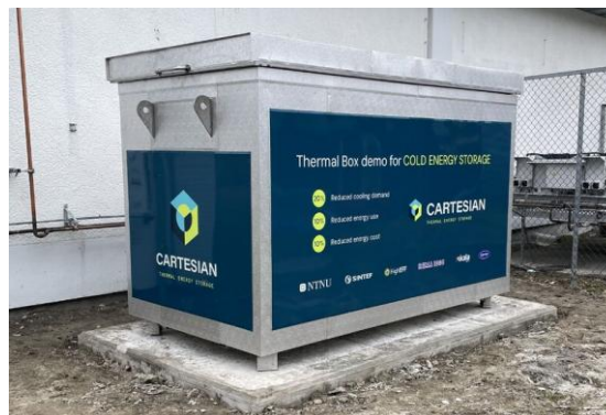
Et av Cartesian sine demo-anlegg for lagring av kuldeenergi. Foto: Cartesian
